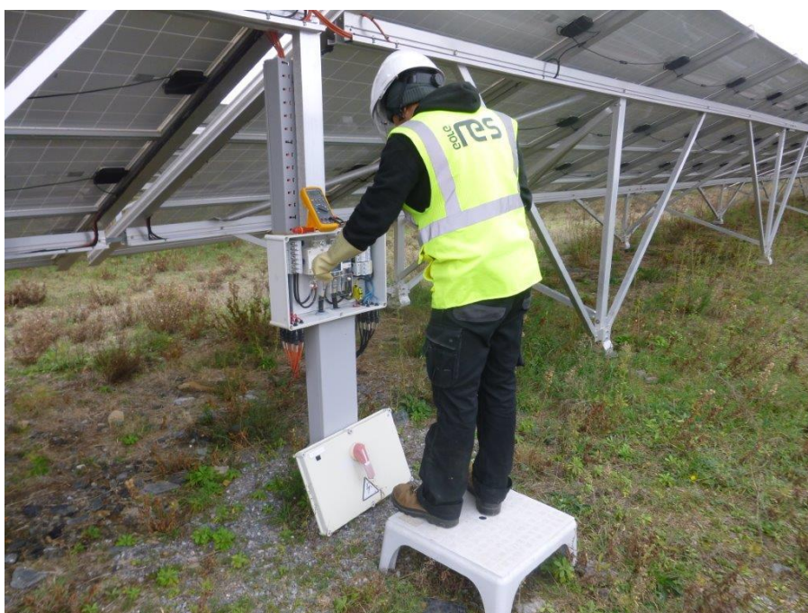
Figur 7. Kontroll av växelriktare på RES solcellspark i Frankrike.
