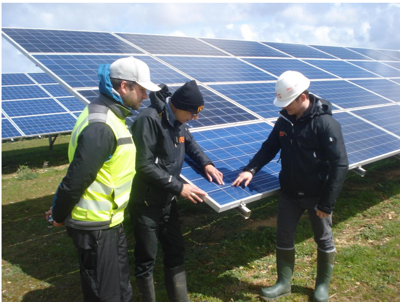
Figur 8. RES personal kontrollerar solcellspanelerna.
