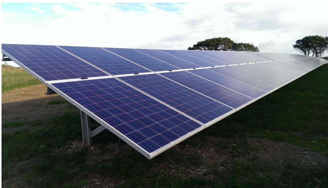
Figur 5. Exempelbild med paneler monterade två och två på högkant ovan varandra
